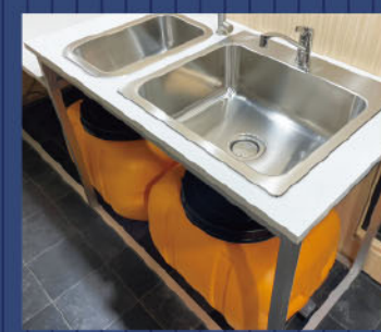
100ℓ給水・排水タンク
